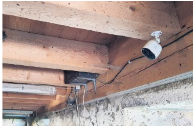
Damit die Kamera langfristig funktioniert, sollte sie IP 65 oder besser IP 66 aufweisen. Damit wird ein Schutz vor Staub und Spritzwasser gewährleistet. (Bild, Markus Bucheli)
