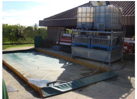
Mobiler Befüll- und Waschplatz mit Osmofilmanlage in Marcelin, Bild H. Hebeisen
