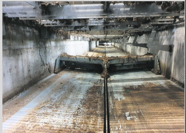
Der Kanalboden des Schweinestalls in St. Gallen (siehe Kasten) besitzt ein Gefälle und Entmistungsschieber. Alle zwei Stunden wird der Kot dann in den Sammelkanal verfrachtet. (Bild: Markus Bucheli)
