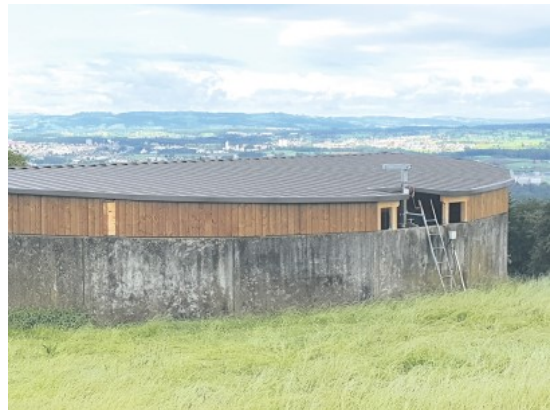
Abdecksysteme mit Holz, ergänzt mit isolierten Blechpaneelen: Individuelle Öffnungen und Anpassungen sind hier einfacher zu realisieren. (Bild: Markus Bucheli)
